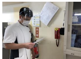
通報装置の確認
